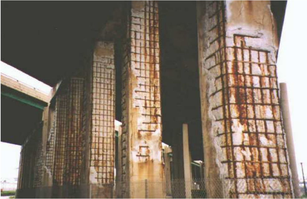
Fig. 5.34. Corrosión del acero en pilotes de un puerto.
